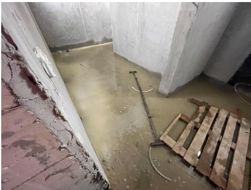
2-расм. Горизонтал ва вертикал конструкцияларнинг туташув жойида сув сизниши
